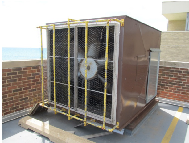
Garage exhaust fan
