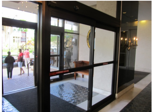
Lobby automatic door
